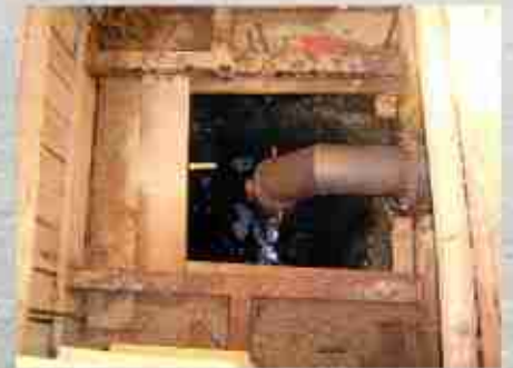
Playa Cifuncho: proyecto de abastecimiento de agua de mar para la Planta Las Luces.
