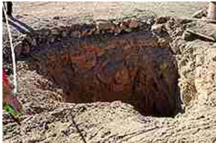
Primer día de Mina Tropezón. El pique de extracción se recibió en estas condiciones.
