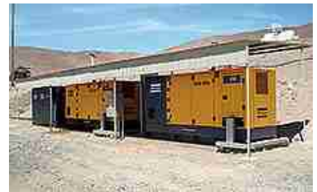
Grupos generadores GAS 250 y compresor GA 110.
