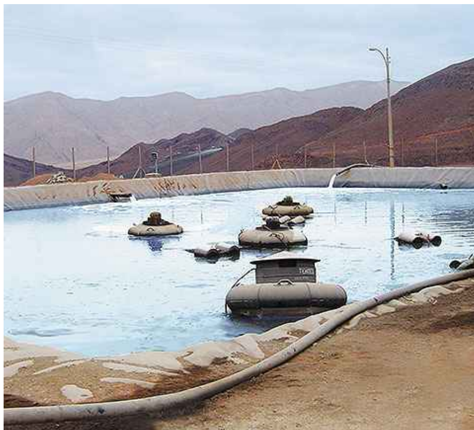
Piscina de agua industrial, Cifuncho, Taltal.
