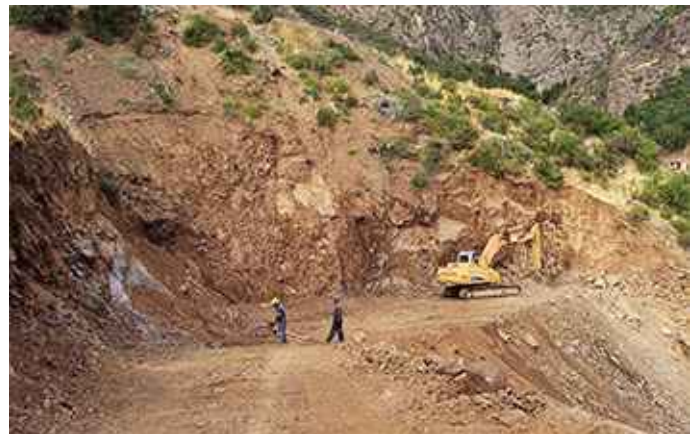
PUNTO DONDE SE CONSTRUIRA EL PORTAL DEL NIVEL INTERMEDIO DE LA MINA (NIVEL 950).
